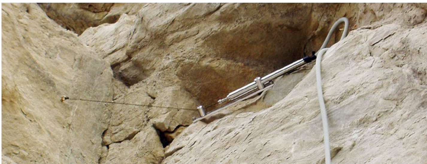
Deformímetro eléctrico instalado en deslizamiento rocoso
